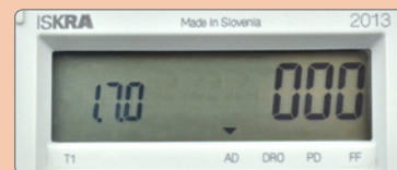
Register 1.7.0 Aktuálny odoberaný výkon (P+) kW
